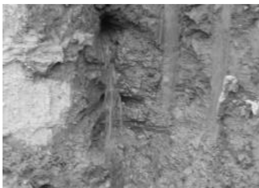
图 8 开挖后漏水点的漏水情况
